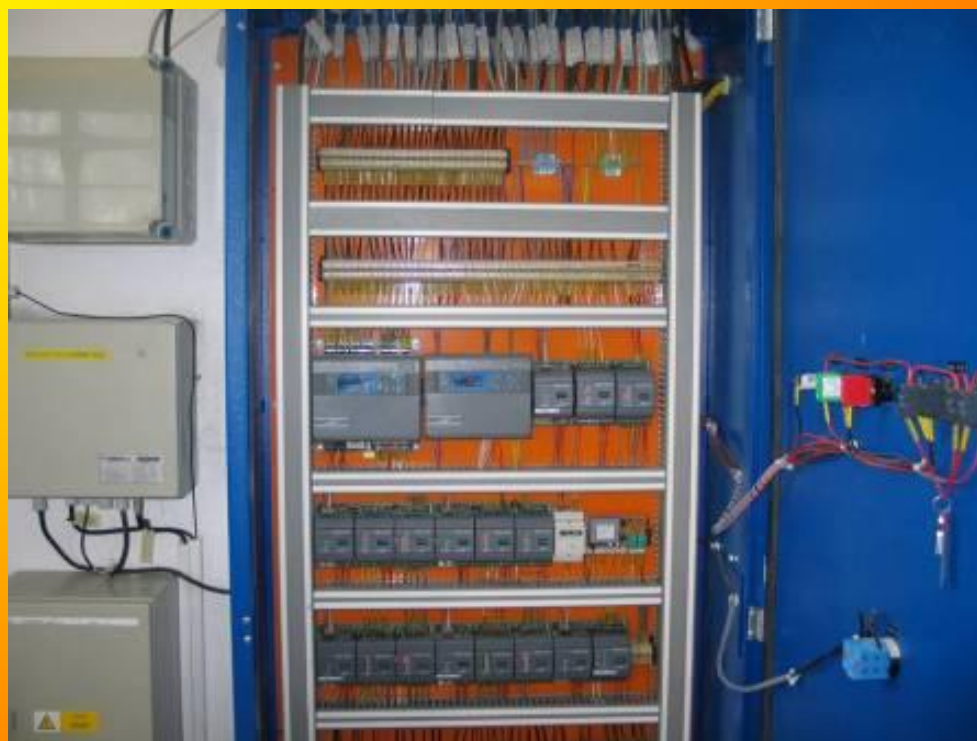
Riadiaci systém Johnson Controls – automatické riadenie chodu kotolní
